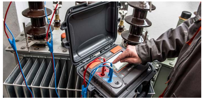
Messung mit dem MMR-650-Messgerät
